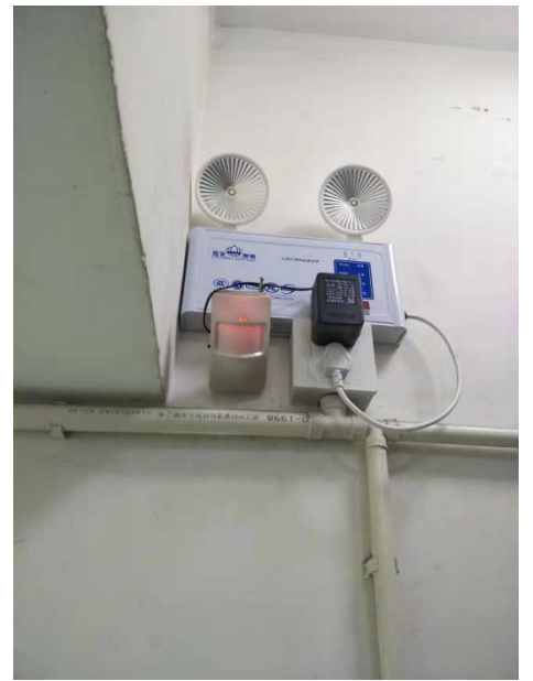
应急照明、红外装置
