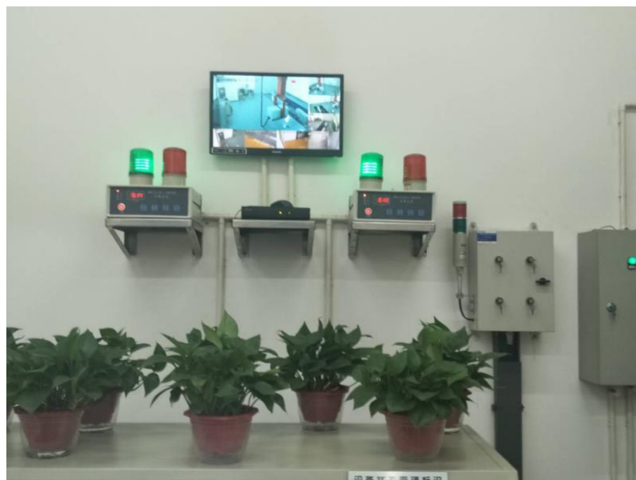
监控装置、固定式在线监测仪、联锁钥匙开关
